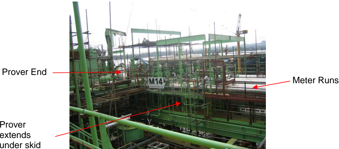
Fig 5 Compact Meter Skid
